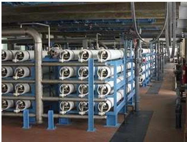
Fig. 9 – Membranas de Osmose Inversa da estação de Porto Santo.
