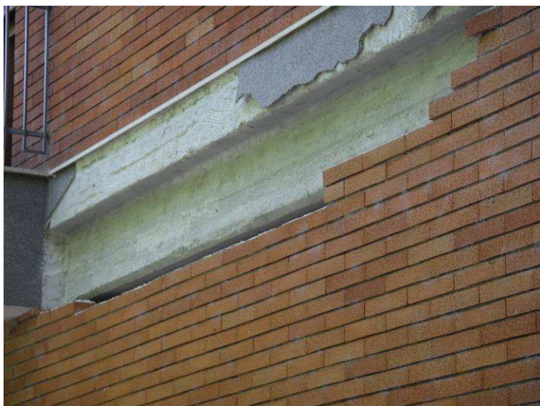
Fraca ligação entre a alvenaria exterior e o betão armado
