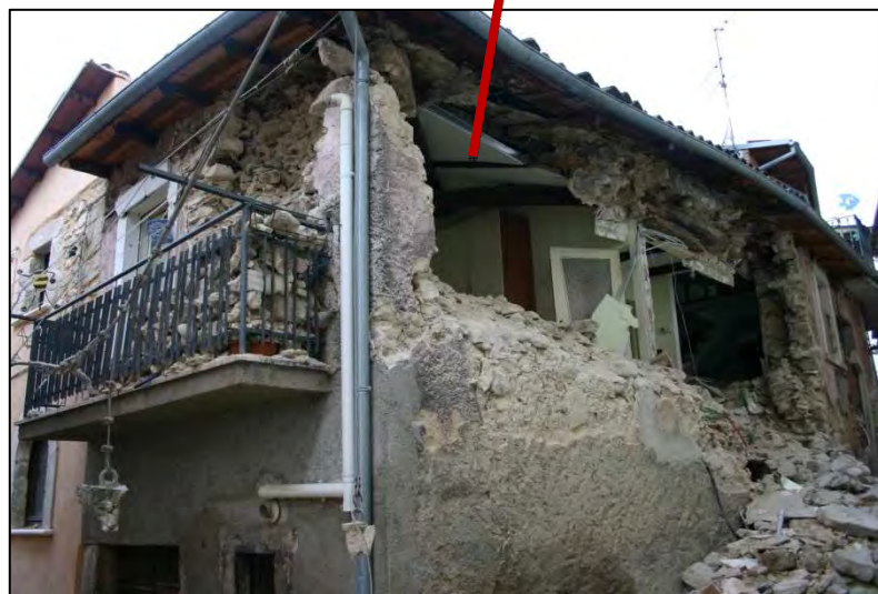
FORMAÇÃO DE MECANISMO E COLAPSO PARCIAL
