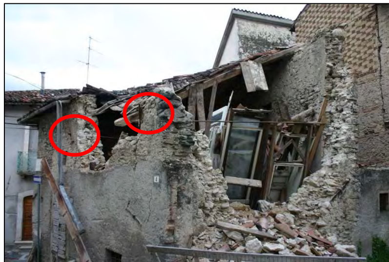
ORIENTAÇÃO DAS ÁGUAS NA ORIGEM DO COLAPSO
