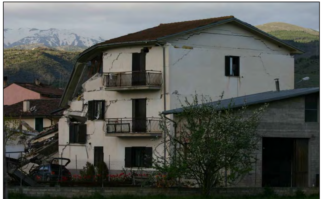
TORÇÃO COMPLETAMENTE VISÍVEL NO EDIFÍCIO
