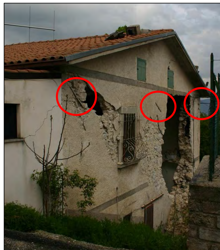
COLAPSO PARCIAL POR ALTERAÇÃO DA ALTURA DE PAREDE SEM TRAVAMENTO
