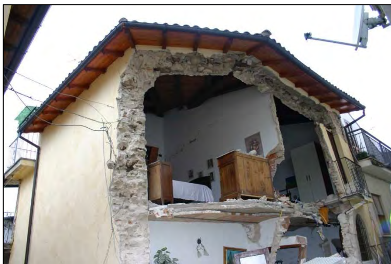
COLAPSO PARCIAL POR EFEITO DO TELHADO E FORMAÇÃO DO SEGUNDO MECANISMO DE COLAPSO FORA-DO-PLANO
