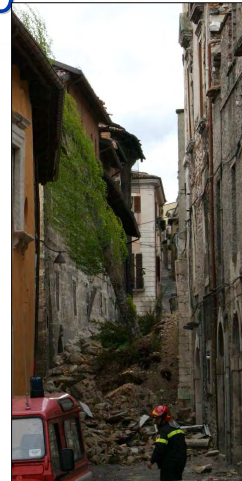
COLAPSO DE MURO SUPORTE
