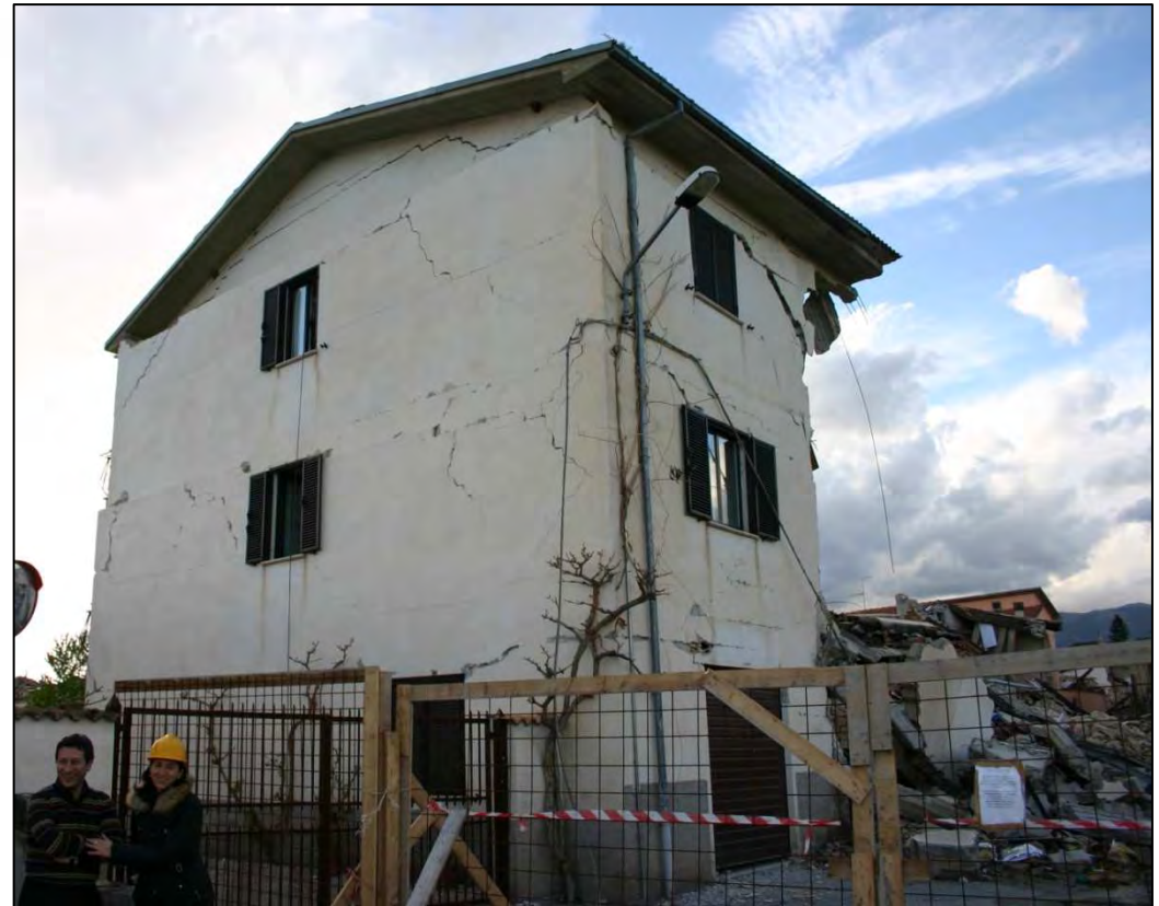
TORÇÃO COMPLETAMENTE VISÍVEL NO EDIFÍCIO
