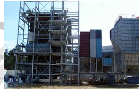
Central de Biomassa de Carregosa (2009); deverá produzir o equivalente à energia consumida por 40 mil habitações e 140 mil habitantes
