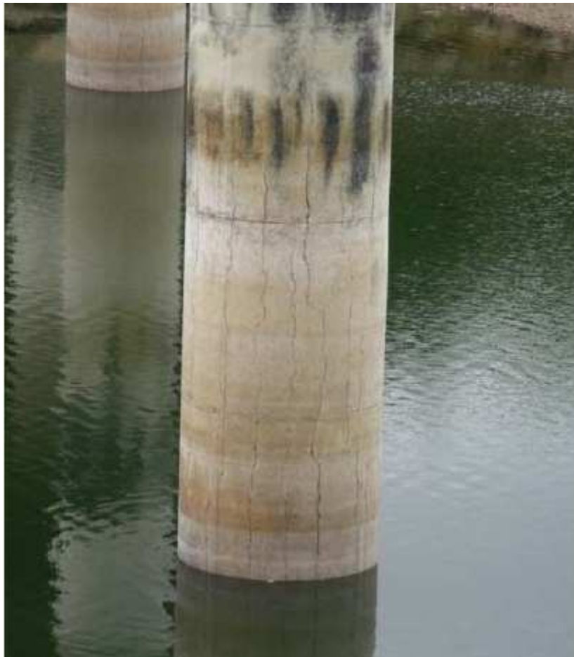
Figura 4 – Fendilhação vertical num pilar de uma ponte localizada na albufeira de uma barragem. A fendilhação ainda não se verifica na zona superficial do pilar, acima do nível máximo da água da albufeira
