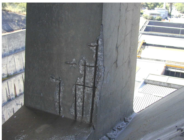
Figura 8 – Fissuração orientada segundo as direcções das armaduras num pilar duma ponte.
