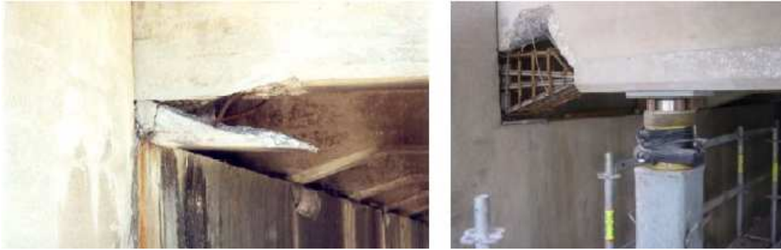
Figura 6 – Esmagamento do apoio de uma viga e reconstrução dessa zona de apoio.
