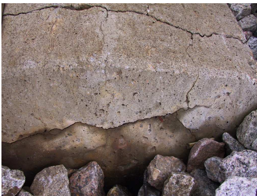
Figura 18 – Elemento pré-fabricado com fissuração decorrente da DEF.
