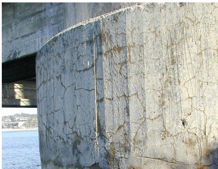
Figura 9 – Descoloração do paramento dum maciço dum pilar numa ponte.
