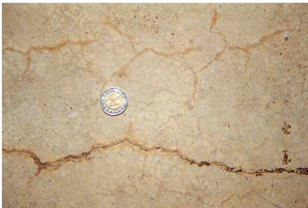
Figura 6 – Fissuração tipo “map-cracking” no pavimento do coroamento numa barragem.
