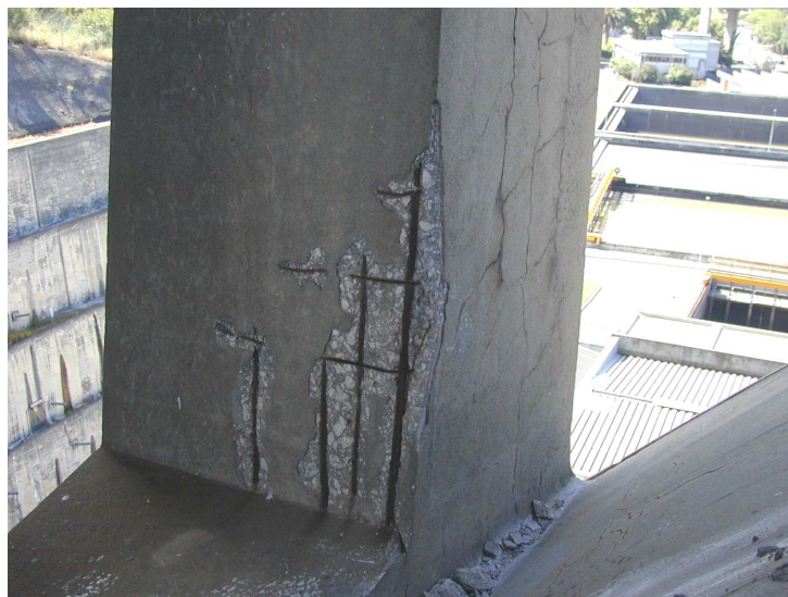
Figura 8 – Fissuração orientada segundo as direcções das armaduras num pilar duma ponte.
