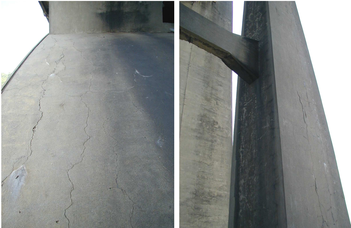
Figura 7 – Fissuração orientada segundo as armaduras principais num arco e num pilar duma ponte.
