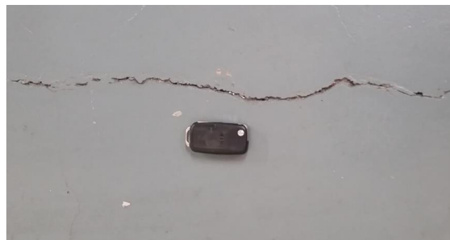
Fig. 4 | Fissura na face superior da laje analisada
