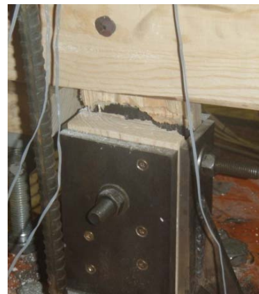
c) Rotura do prumo traccionado no apoio, com uma força de rotura de 45 kN
