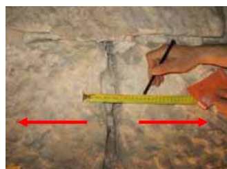
Fig 5 – Abertura de junta entre pedras na parede sobre o arco (zona do desvão)
