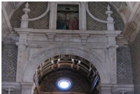
Fig 10 – Aspecto final do arco-cruzeiro após instalação do sistema de monitorização
